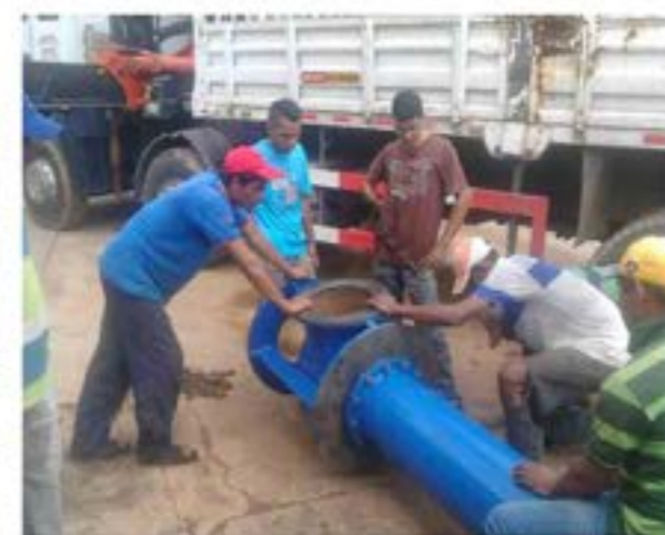
Operativo equipo I en Estación de Bombeo el Bostero-Chaguaramas
